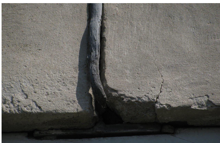
Zarysowane oparcie płyty 3/5
