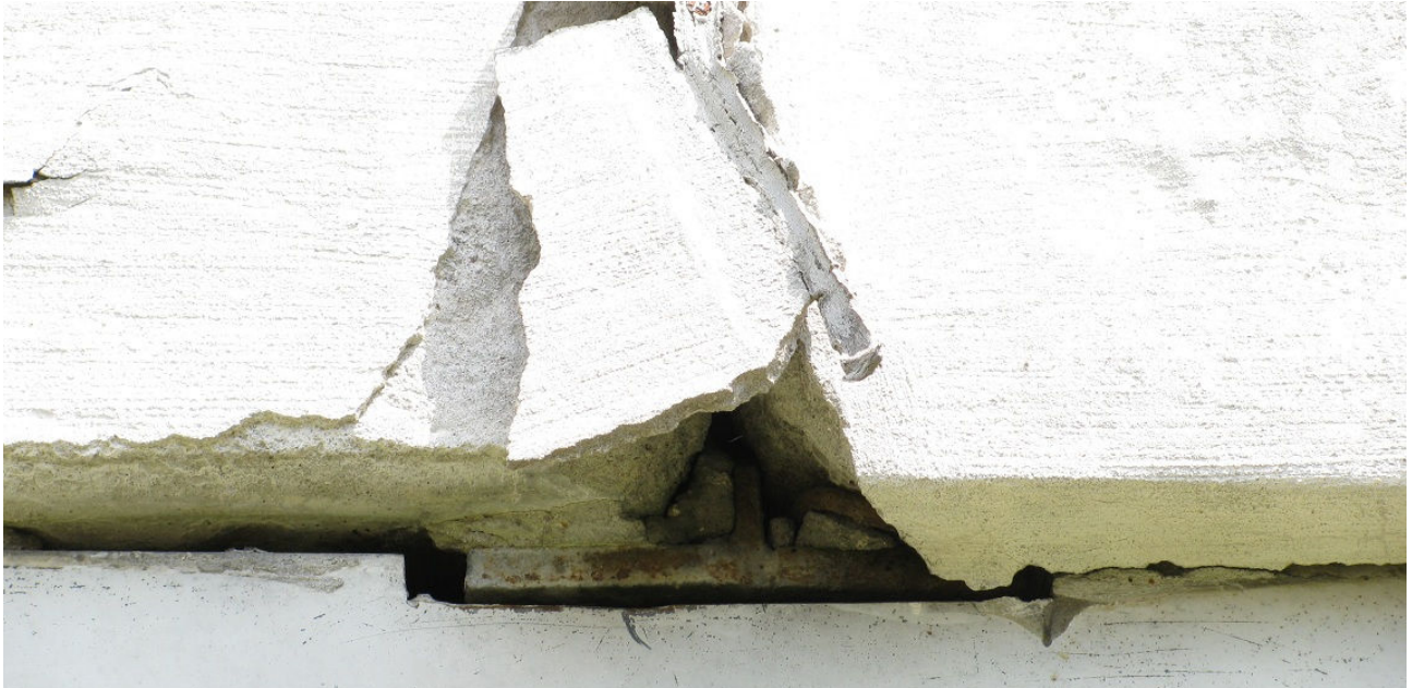
Podparcie dolne płyt 2/2+2/3 elewacji tylnej. Widoczna blacha podpierająca płyty elewacyjne oraz pionowe żebro usztywniające.
